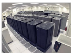
DATACENTER OCH KONTROLLSYSTEM
